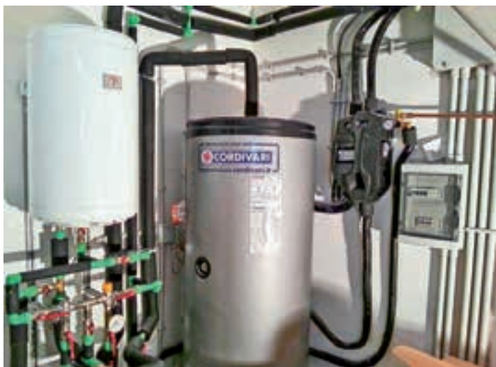
SOLARE TERMICO CON ACCUMULO. L'acqua calda è fornita da tre pannelli solari Baxi installati sulla falda Sud del tetto, collegati ad un accumulo da 400 litri fornito da Cordivari
